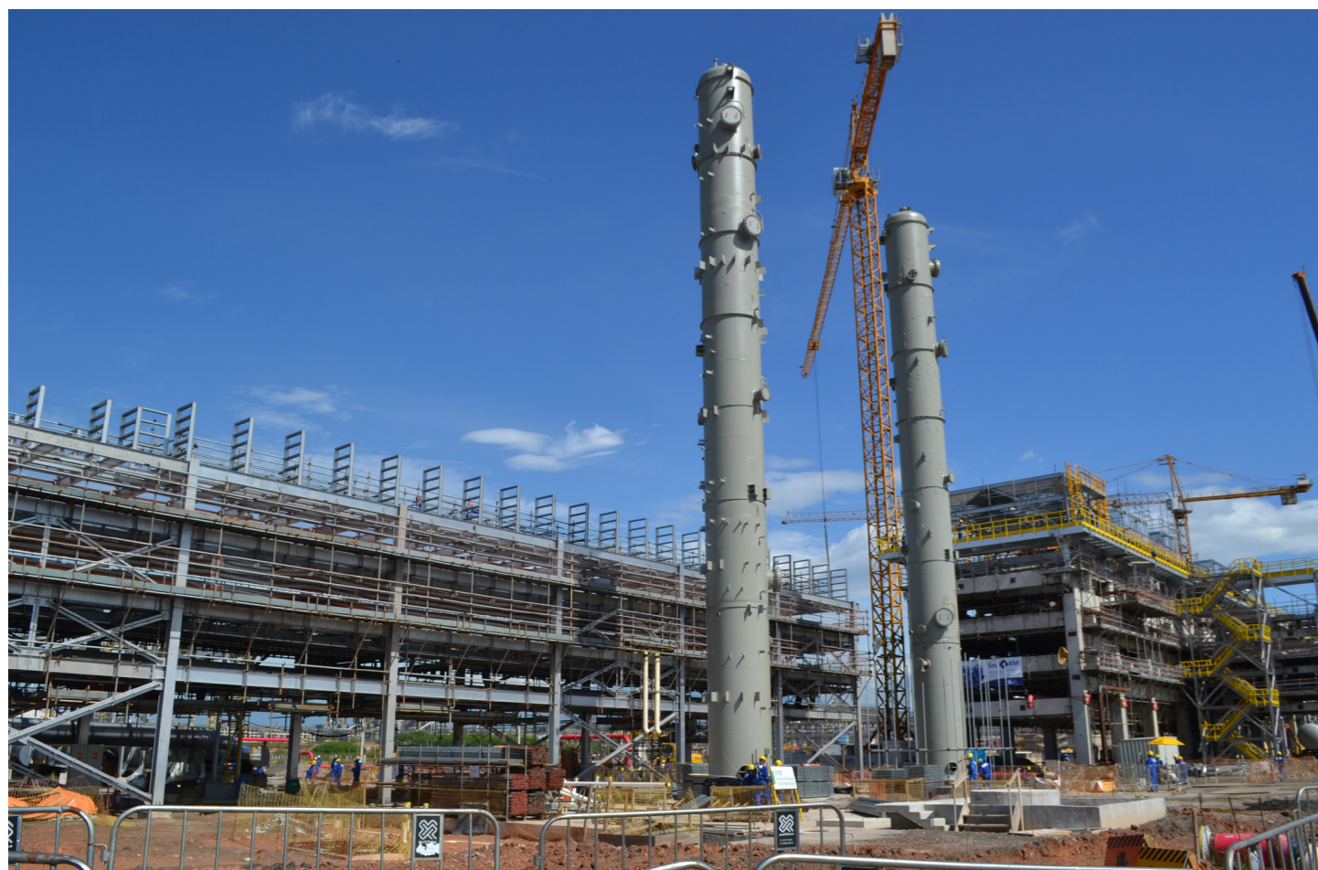
Duas das seis torres de processamento de gás natural instaladas recentemente
